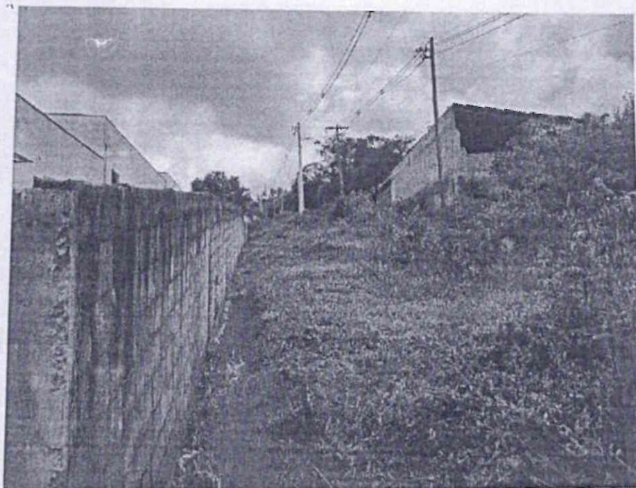
Imagem 04: Enxurrada descalçando muro do condomínio Fonte: Defesa Civil
