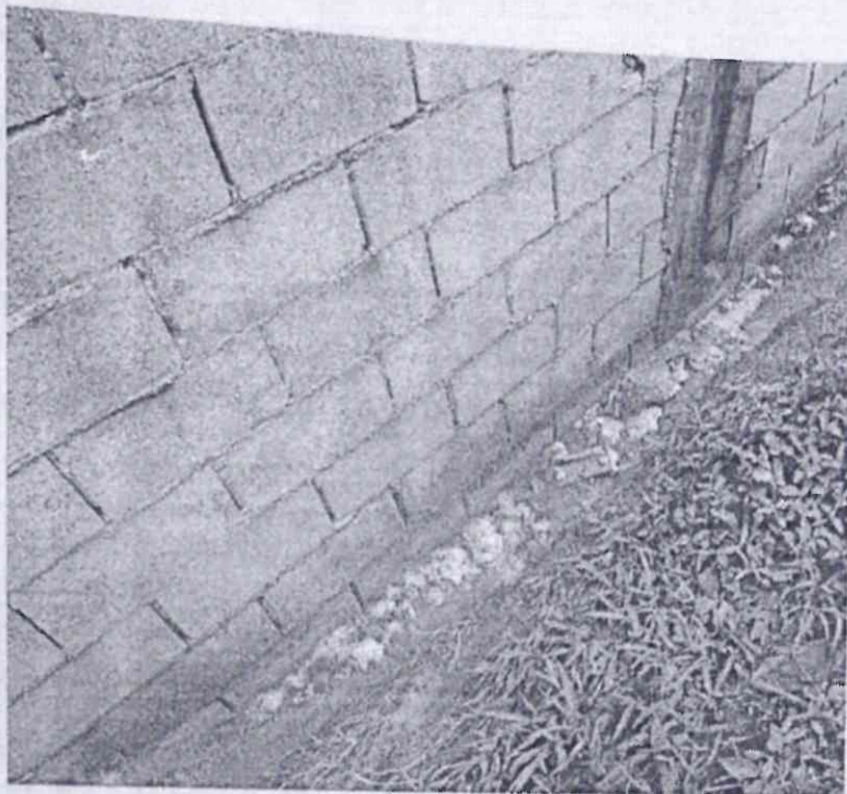
Imagem 03: Fundação do muro exposta Fonte: Defesa Civil
